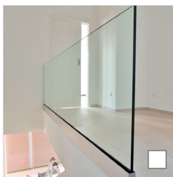
Skleněné zábradlí instalace dle projektové dokumentace doplatek 25 000 Kč/bm
